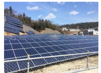
関市の太陽光発電設備
