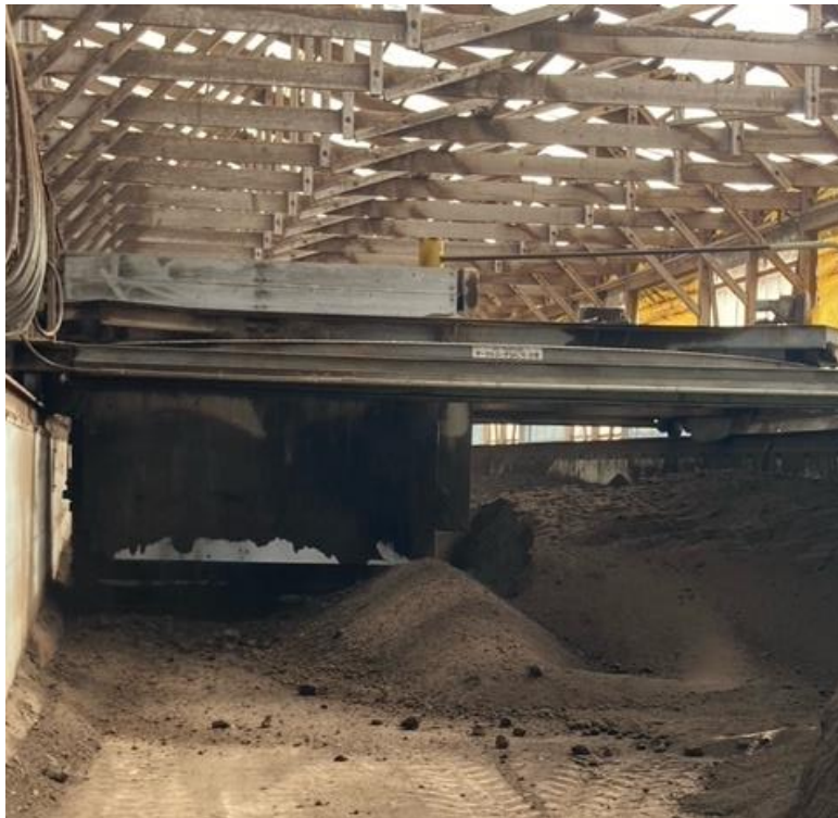
連続発酵乾燥堆肥化处理装置
