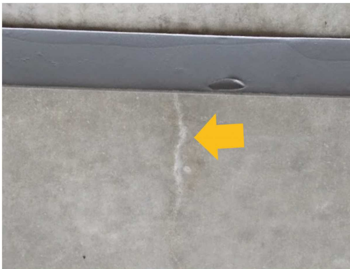
図 5：Basilisk による自己修復の様子（ボックスカルバート頂版内側の自己治癒状況） 10
