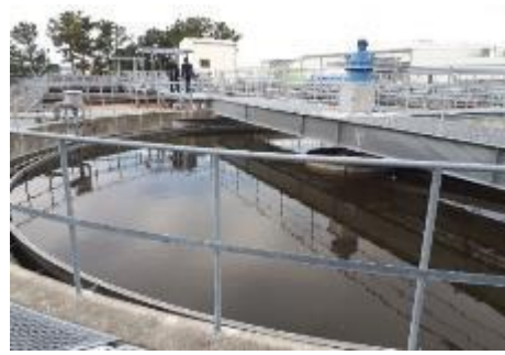
住吉工場の汚水処理施設
