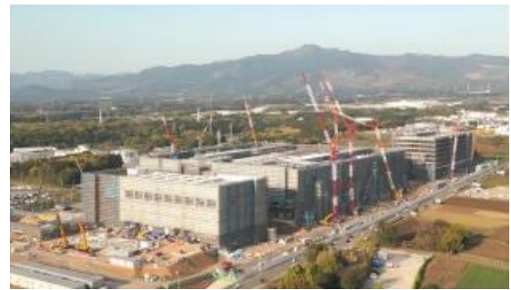
写真⑤ 熊本県菊陽町でのJASM半導体工場建設の様子 （出典：経済産業省「半導体・デジタル戦略」資料より抜粋）
