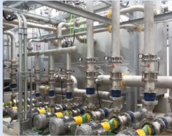
(プラント配管)
