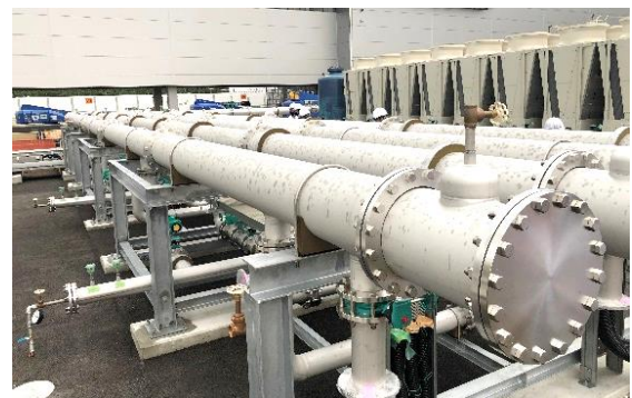
写真⑥ 阿蘇くまもと空港で施工した配管設備 （出田産業提供）
