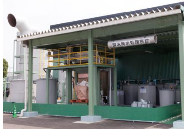
写真⑬ 酸洗設備の浄化装置 (出田産業提供)
