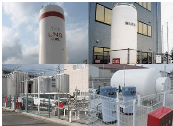
高圧ガス設備定期検査 (出所) ナカテック HP より
