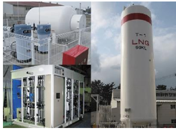
高圧ガスプラント設計施工 (出所) ナカテック HP より
