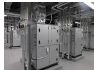
<空調システム>
