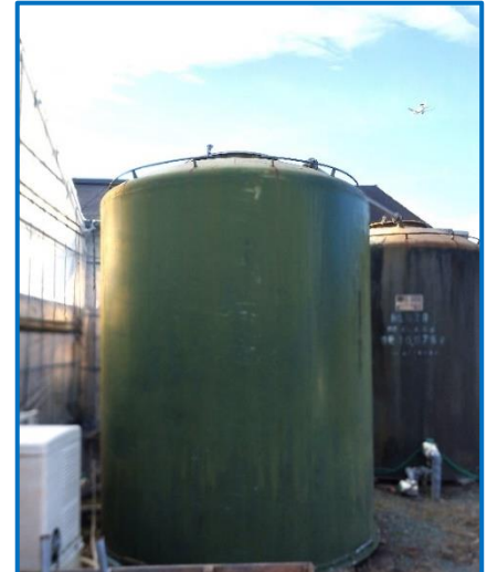
【地下水のくみ上げ用ポンプと貯水タンク】
