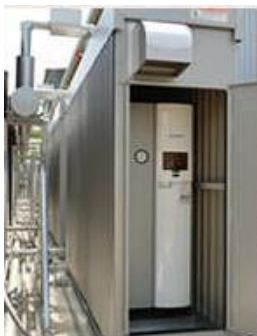
写真⑬ ボイラー
