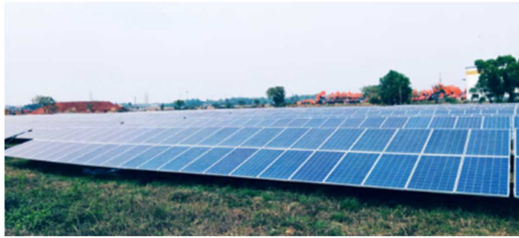
図 10 カラグプール工場敷地内に設置された太陽光パネル 10
