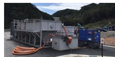
濁水処理装置
