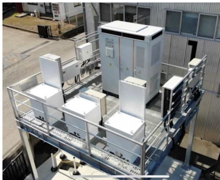
<工場に設置した蓄電池>
