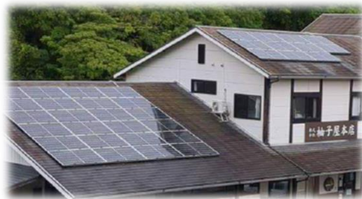
添付㉘ 本社工場屋根に設置されている太陽光パネル
