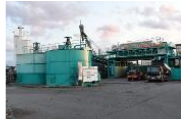
③分別脱水プラント(静岡県設置)
