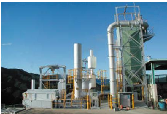
写真⑦ 焼却施設 出典：当社提供
