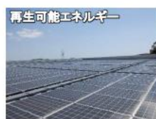
太陽光発電設備の整備
