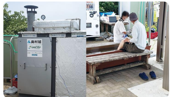
地元の竹材を使ったバイオマス発電設備による足湯
