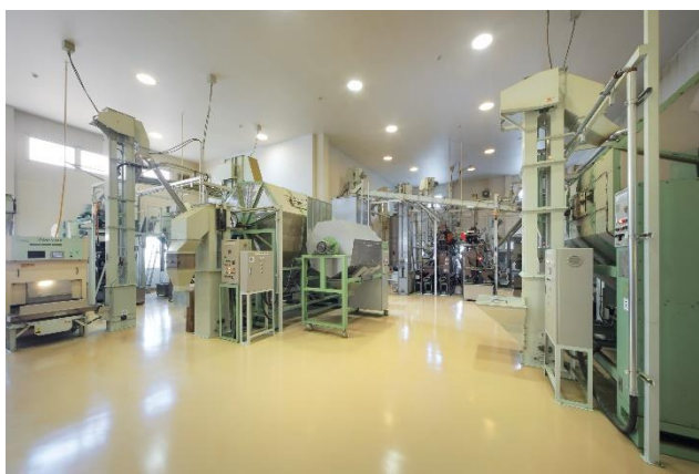
▲FSSC22000 認証を取得したクリーンな工場内の様子
