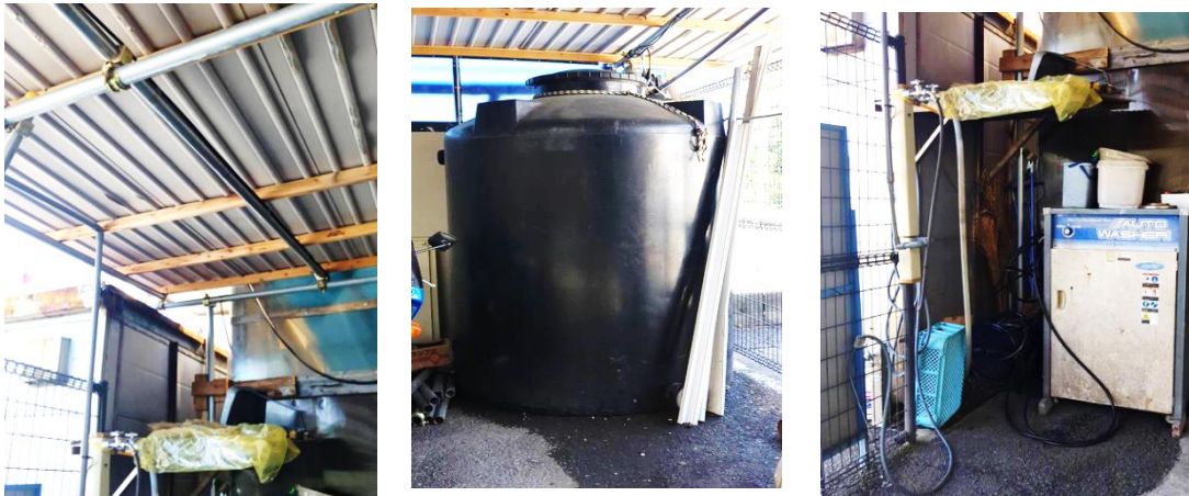
写真⑤ 左から雨受け屋根及び雨水パイプ、貯蔵タンク、雨水利用洗浄機
