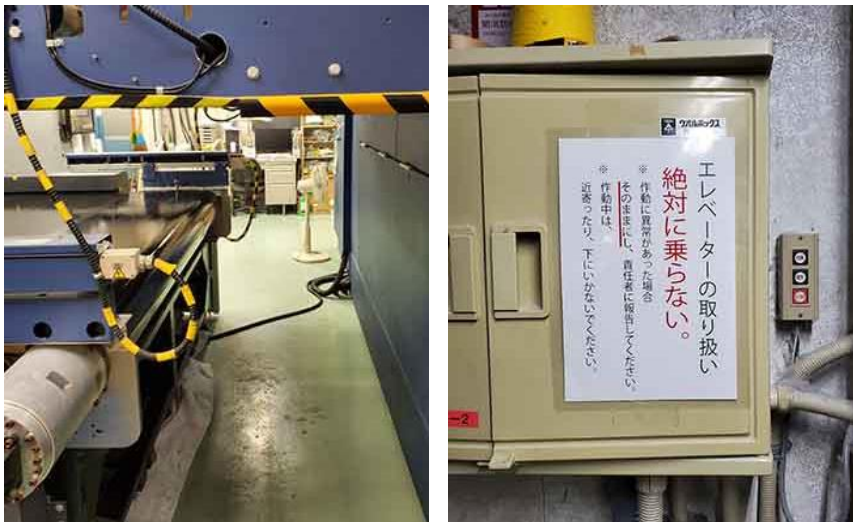
(写真⑦) 左:危険箇所へのスポンジ貼付 (黄と黒色のストライプ)
