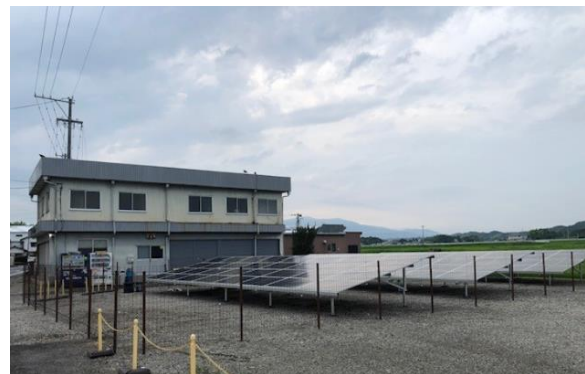
工場敷地に設置された太陽光パネル～当社より提供
