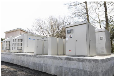
基礎上げたキュービクル
