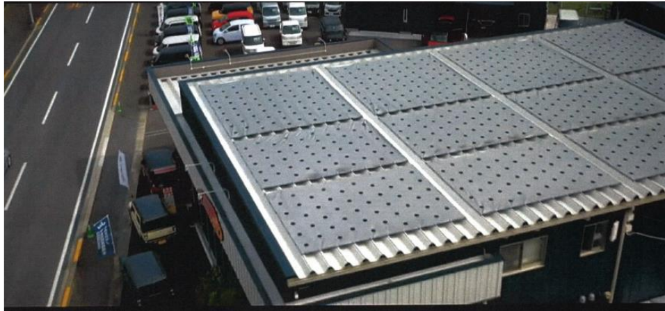
本社屋上の遮熱シート 出典：当社 HP より
