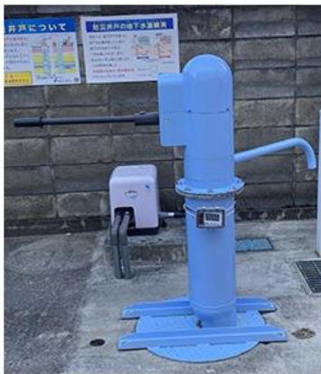
○本社防災井戸（大宮事務所）
