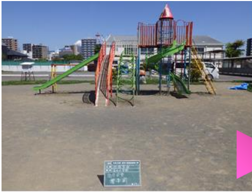
作業前：塗装が傷み、錆も目立つ。
