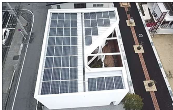
（高崎モデルハウス 太陽光発電設備設置例）
