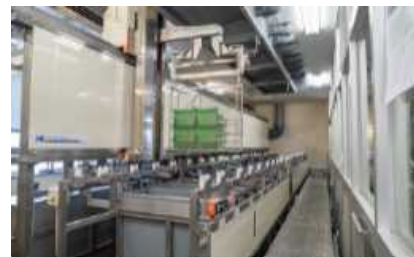
無電解金めっき&無電解銅めっきライン
