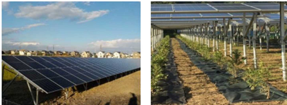
図表 20 (左) 低圧・分散型太陽光発電設備 20 、(右) ソーラーシェアリング 21
