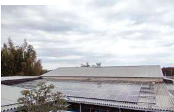
太陽光パネル
