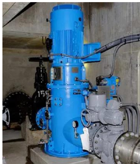
図10:立型インライン水車設置後写真
