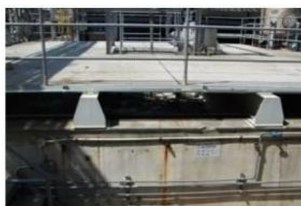
微生物処理設備
