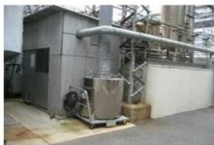
活性炭脱臭器
