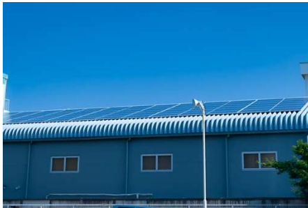
村山工場屋根に設置された 太陽光パネル
