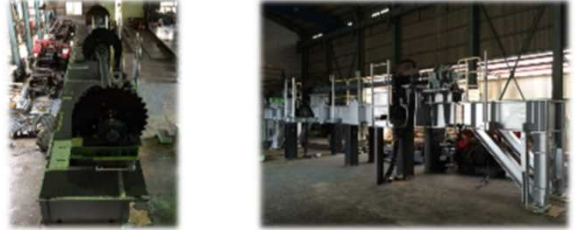
厚板工場 スラブ昇降装置 (韓国+本社)
