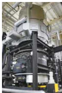
図 13 コマツ栗津工場のバイオマス蒸気ボイラ 15
