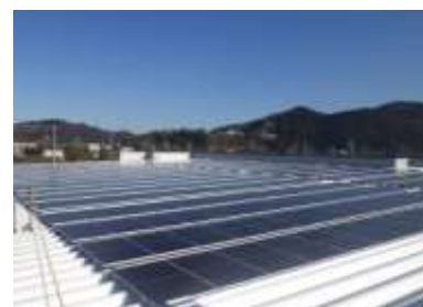
店舗屋上に設置した太陽光発電パネル
