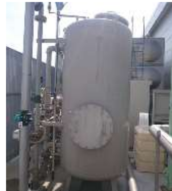
深井戸・濾過設備(物流センター)
