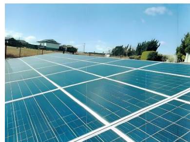
<太陽光発電設備>
