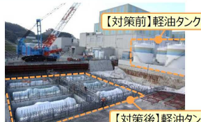
非常用ディーゼル発電設備 軽油タンクの地下化 (3号機)
