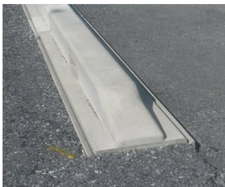
防草ブロック
