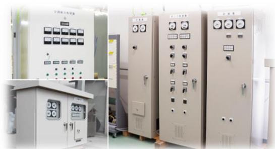
図②：制御盤システム事業
