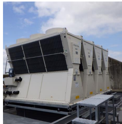
空冷チラーユニット
