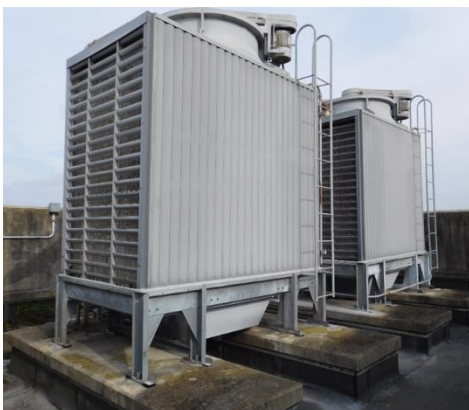
油焚冷温水発生機 冷却塔
