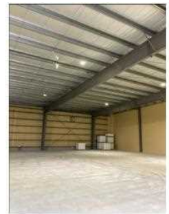
倉庫内LED化
