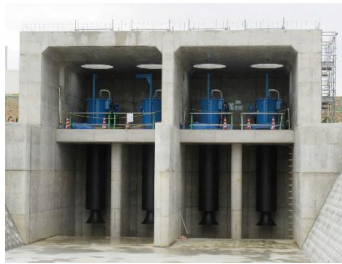
小川内水排除設備 ・発電機 750kVA 2機 ・京都府木津川市/2024年3月
