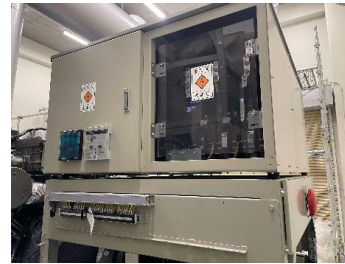
白浜町平浄水場向け発電機 ・発電機 1,000kVA ・和歌山県西牟婁郡/2023年6月
