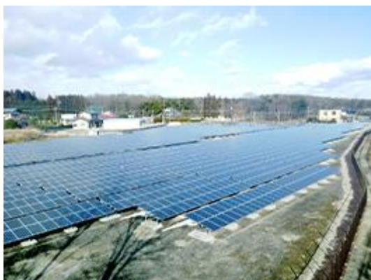
那須塩原市の太陽光発電設備
