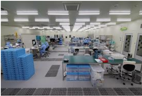
クリーンルーム
