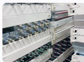
ヘッドエンド設備
