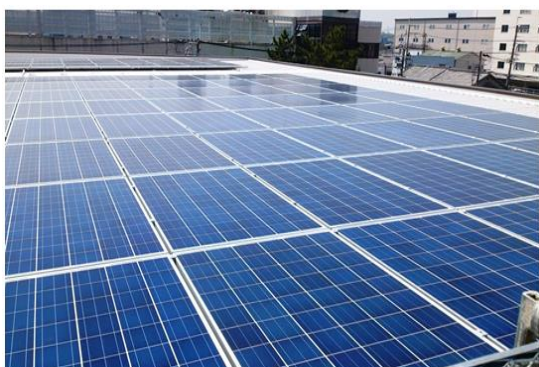
〈本社社屋 太陽光パネル〉
