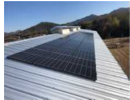
黒瀬工場の太陽光パネル
